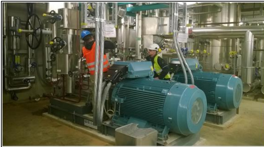
Şekil 13. Ana Besi Suyu Su Pompaları
