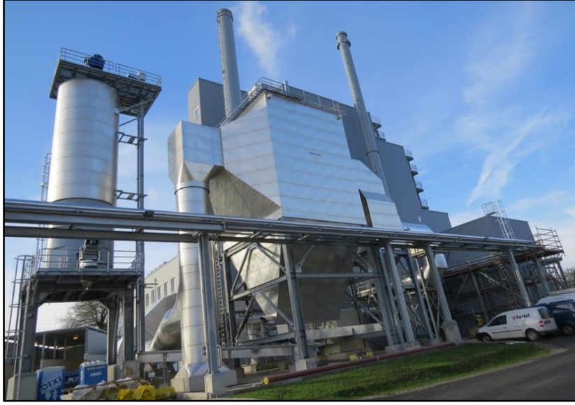
Şekil 17. Örnek Bir Tesiste Kül Silosu ve Filtre
